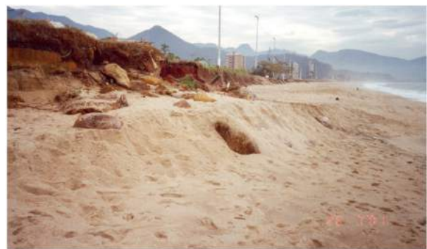
Figura 4. Erosão acelerada no setor centro-sul da Praia de Massaguaçu, com destruição recorrente da saia de aterro e da pavimentação da rodovia BR-101 (Celia R. de G. Souza). Notar a tentativa frustrada de conter a erosão através de um anteparo de blocos rochosos. Figure 4. Accelerated erosion in Massaguaçu Beach, around its center-southern portion (Celia R. de G. Souza). Note the rocky boulders revetment as a frustrated bid for containing the erosional process on the BR-101 highway.
