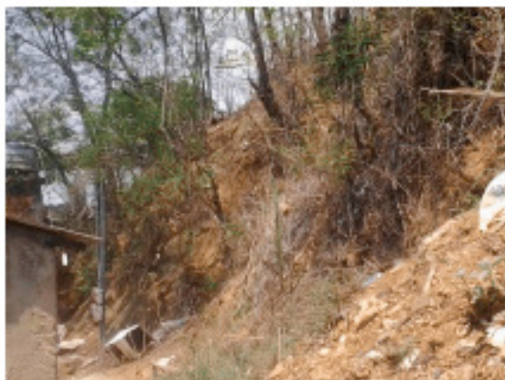
Figura 2 – Corte de talude em ângulo de aproximadamente 90° e erosão intensa do solo, próximo à residência e sem obra de contenção.
