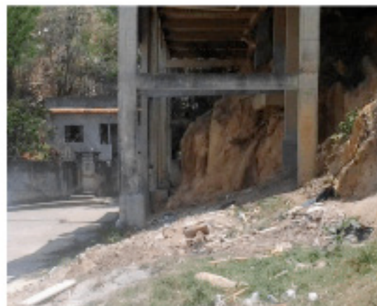
Figura 3 – Bases estruturais de construções aparentes e degradadas, associadas à erosão do solo.
