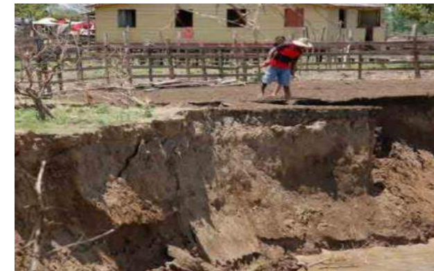
Figura 22 Solapamento de margem provocado por erosão fluvial . 9
